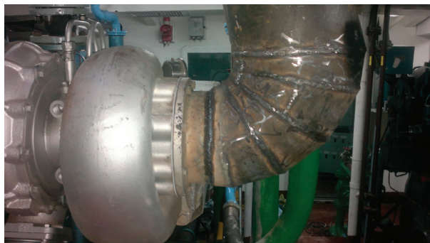
图4 改正后的排气管
